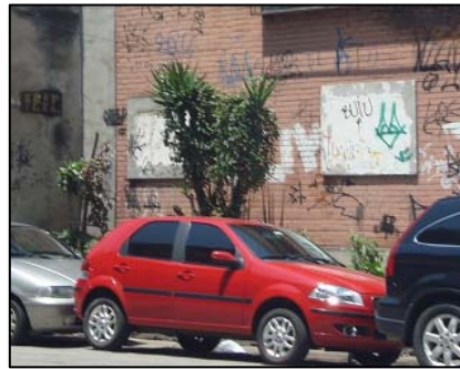
Pichações nas Edificações
